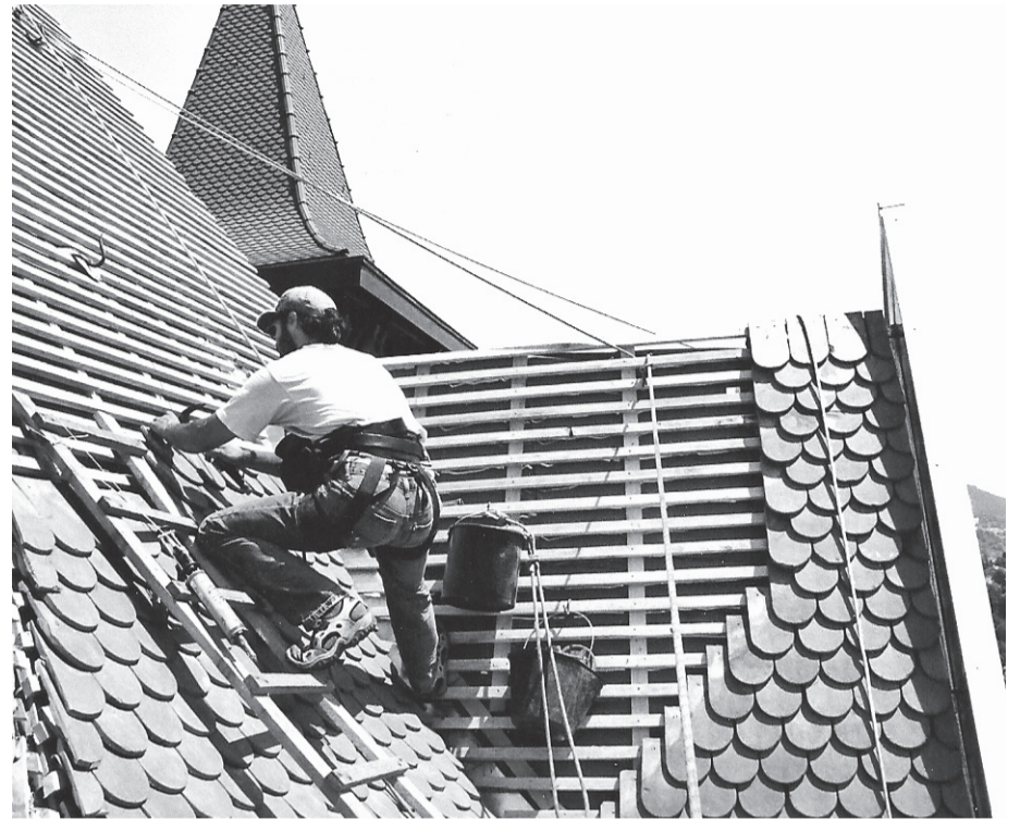
Lolo bij het dekken van het dak van een oud landhuis. Vier jaar lang heeft de timmermansgroep van Treynas gewerkt aan de restauratie van dit huis, dat eigendom is van een bevriende houthandelaar uit de streek.
