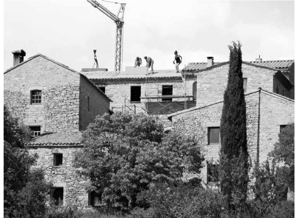
Het bouwwerk St. Hippolyte: het laatste gedeelte heeft nu ook eindelijk een dak.
